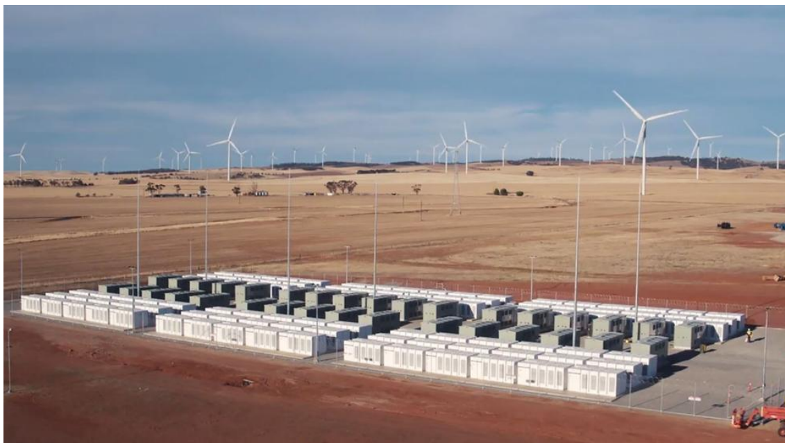
Fig. 4.B.1-1 Usos de baterías estacionarias en la red eléctrica (Tesla BESS)
